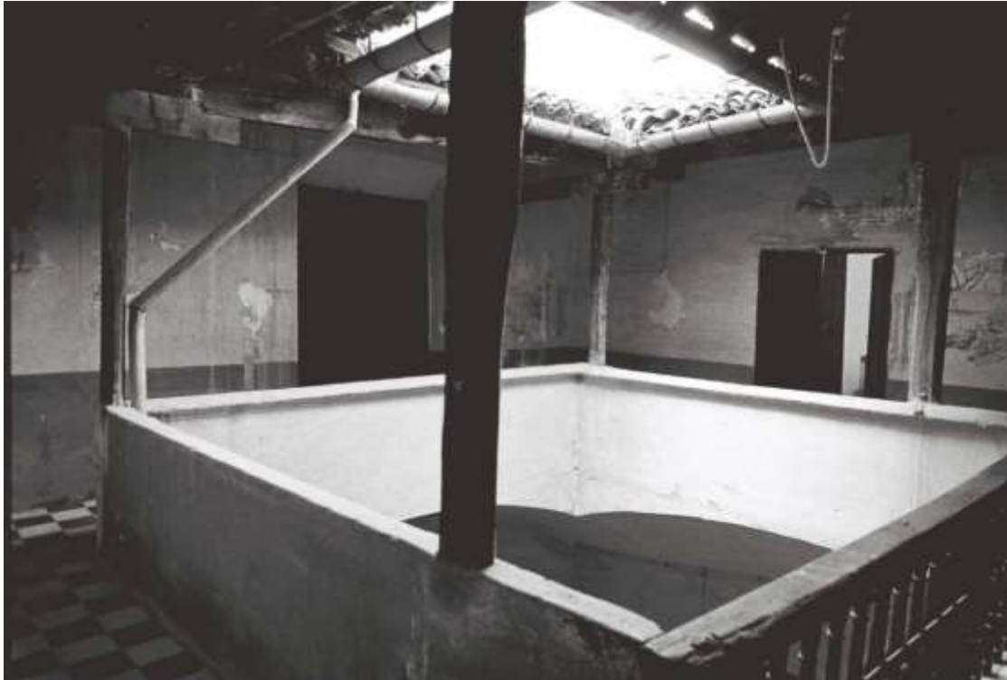
Corredor de la primera planta, amb els ràfecs de les teulades recolzats en tornapunts i peus drets de grossera i ruda execució. Foto JMC. 1993
