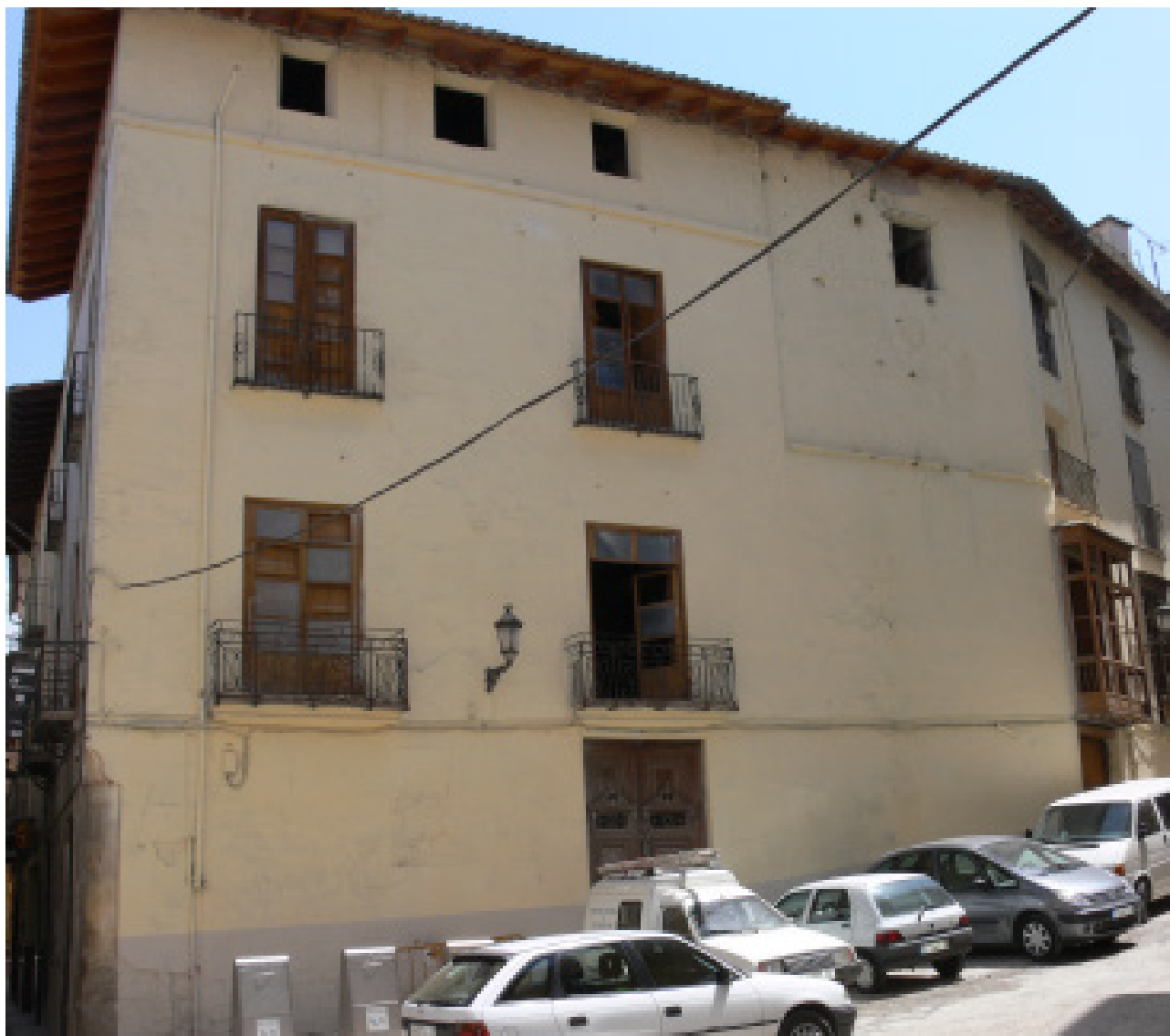
Façana de la casa que dona a la plaça de Mayor. S'observa una discontinuïtat en el ràfec de la teulada de la caixa de l'escala que cus el cos principal amb el meridional. Foto MGB, 2007
