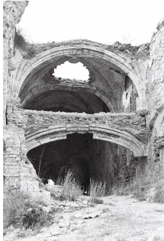
Façana i primera crugia esfondrades. Foto JMC
